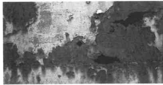
Abb. 2: Chemische Korrosion an einem unbehandelten Bauteil
